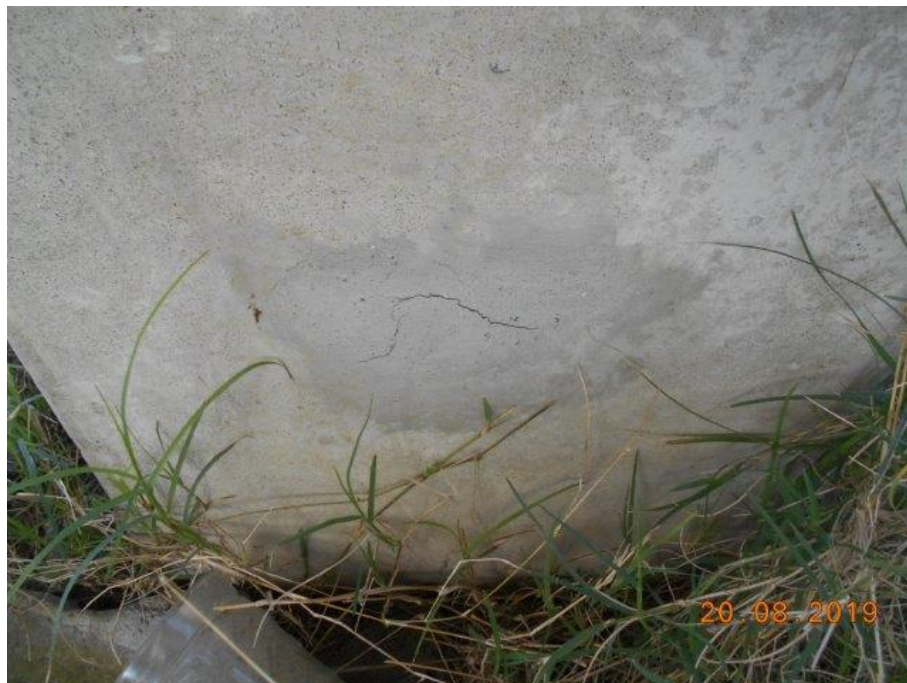
Foto 78 Defeito em reparo no pilar P3, face Sul.
