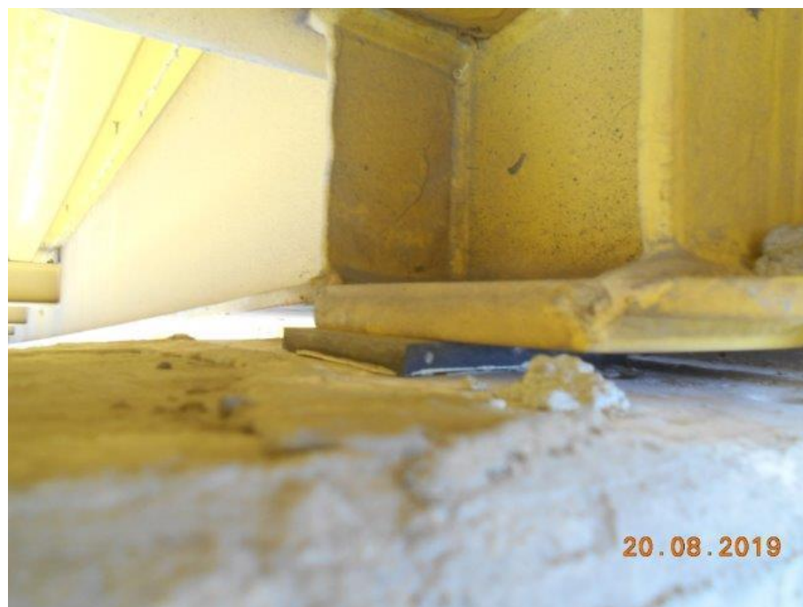
Foto 19 Aparelho de apoio AA15 mal posicionado.
