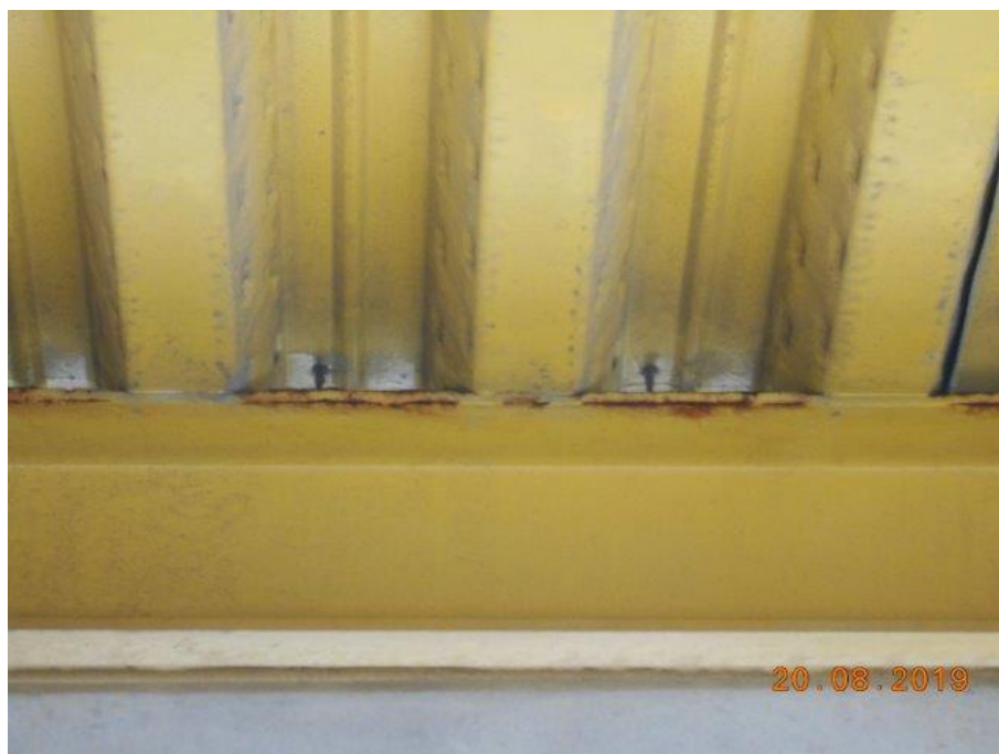
Foto 60 Oxidação superficial no perfil longitudinal do vão 4.
