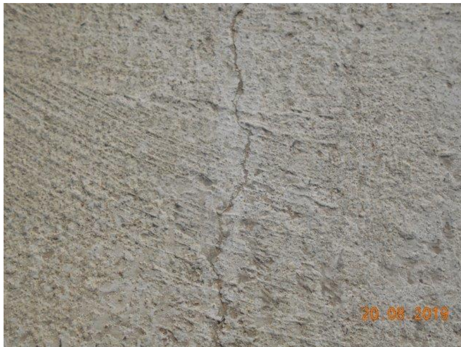
Foto 84 Fissura com posicionamento e abertura máx. de 0,3mm no piso do acesso ao encontro Leste.
