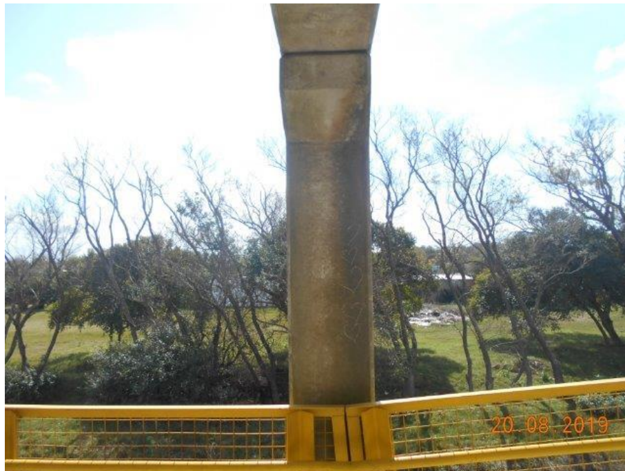
Foto 83 Mancha de umidade no pilar P21, face Oeste.
