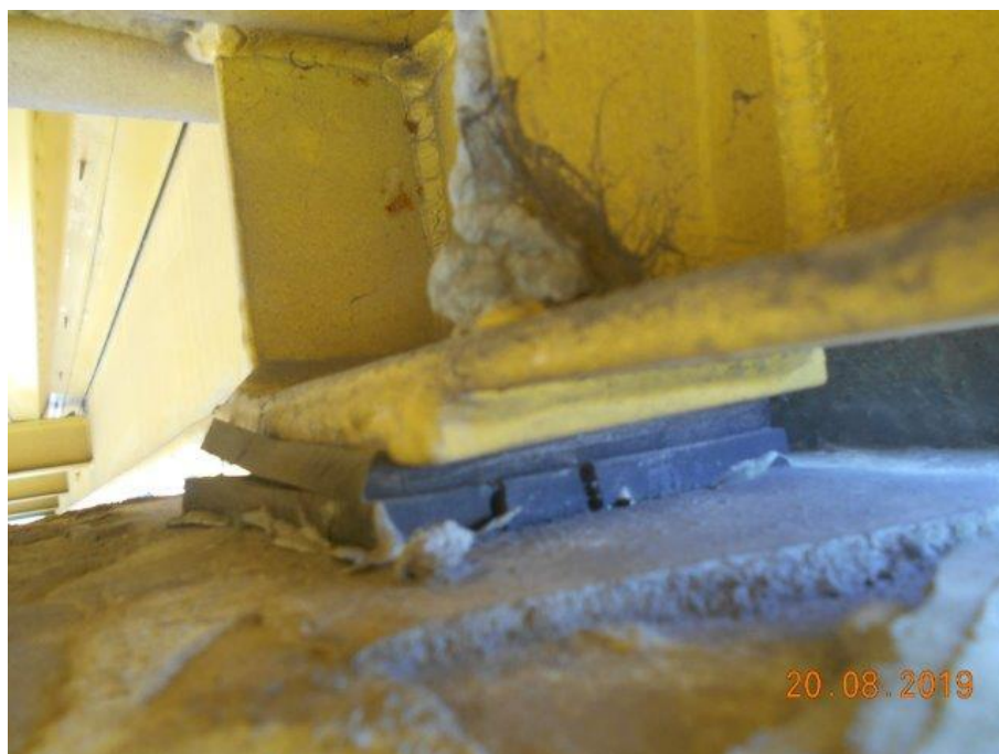
Foto 38 Aparelho de apoio AA59 deformado, mal posicionado e instalado em pedaços isolados e justapostos para atingir a altura necessária.
