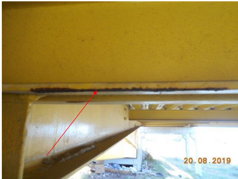
Foto 59 Oxidação superficial no perfil transversal, face Norte do patamar 2.
