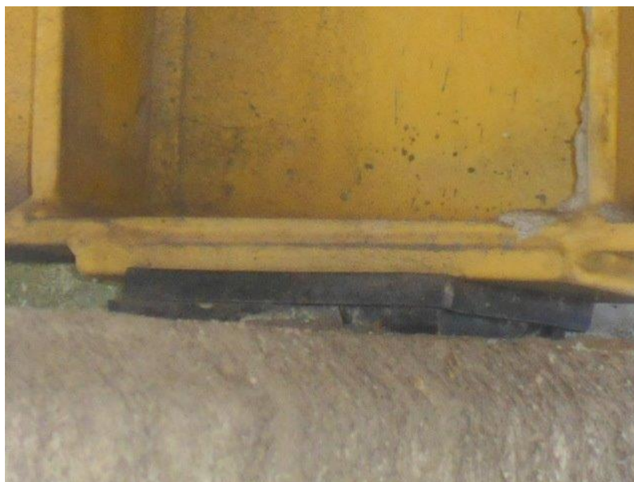
Foto 16 Aparelho de apoio AA9 mal posicionado devido à falta de berço. Foram instalados dois aparelhos justapostos para atingir a altura necessária.
