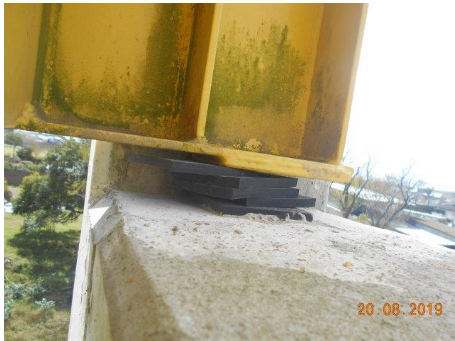
Foto 32 Aparelho de apoio AA44 com incríveis 5 (!) aparelhos justapostos, com posicionamento irregular e ainda assim com funcionamento inoperante.
