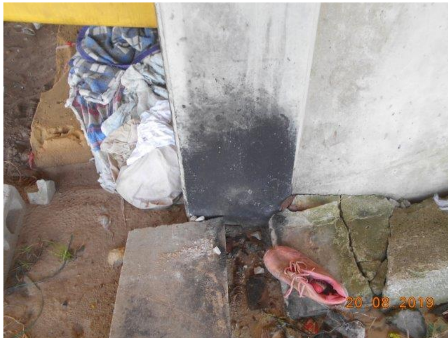
Foto 81 Mancha de fuligem no pilar P4, face Oeste.
