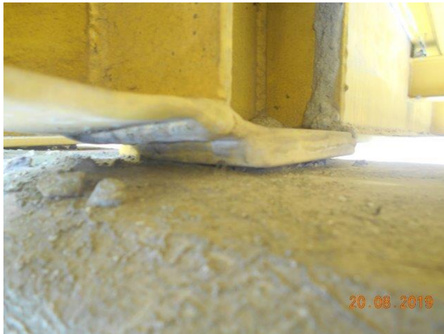
Foto 37 Aparelho de apoio AA55 esmagado.
