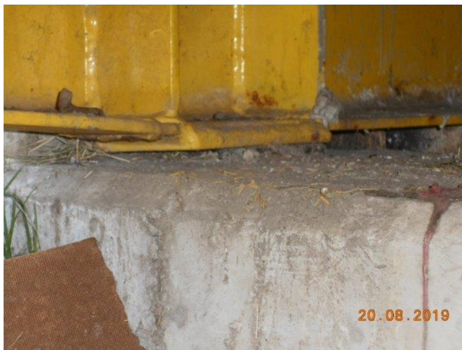
Foto 15 Aparelho de apoio AA8 obstruído.
