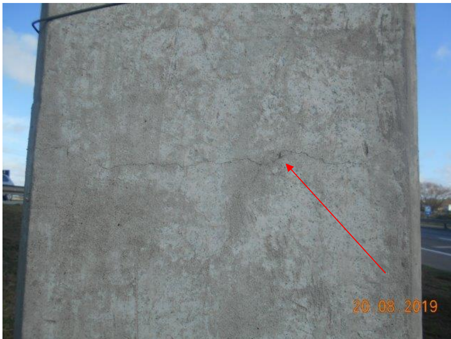
Foto 74 Fissura com posicionamento horizontal e abertura máxima de 0,3mm no pilar P14.
