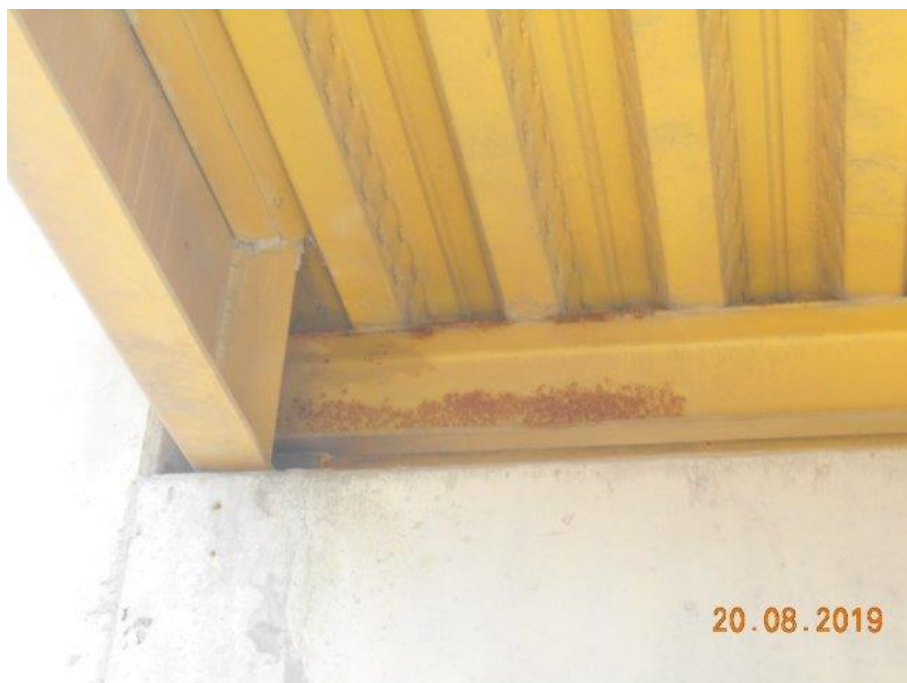
Foto 68 Oxidação superficial no perfil transversal, faces Norte e inferior do vão 9.
