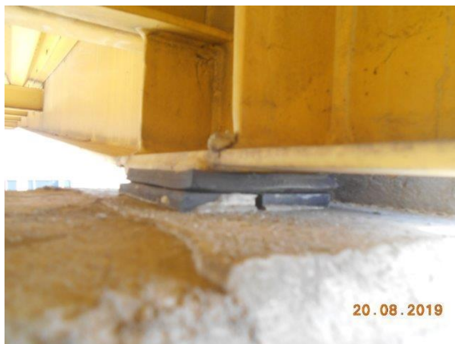
Foto 20 Aparelho de apoio AA16 mal posicionado, instalado em pedaços isolados e justapostos para atingir a altura necessária.
